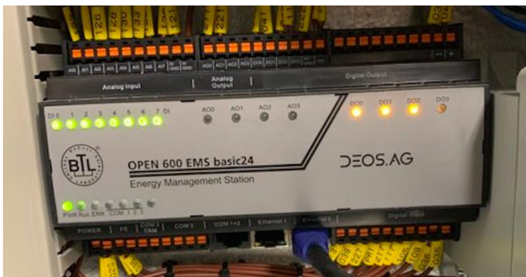
Fig.15 Installerad DEOS DUC i flerbostadshuset.
