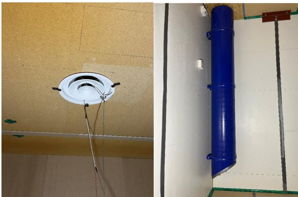
Figur 2: Ombländande tilluftsdon till vänster (med en anemometer) och deplacerande tilluftsdon till höger.
