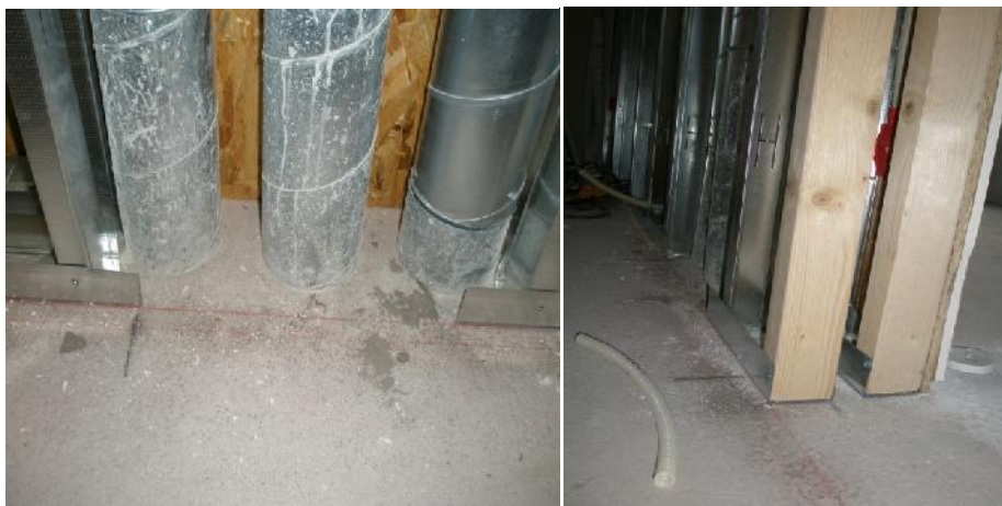
T.v. Bild 4.5 Rördragning i innervägg med utökad tjocklek (Fornstedt, J, 2012)
