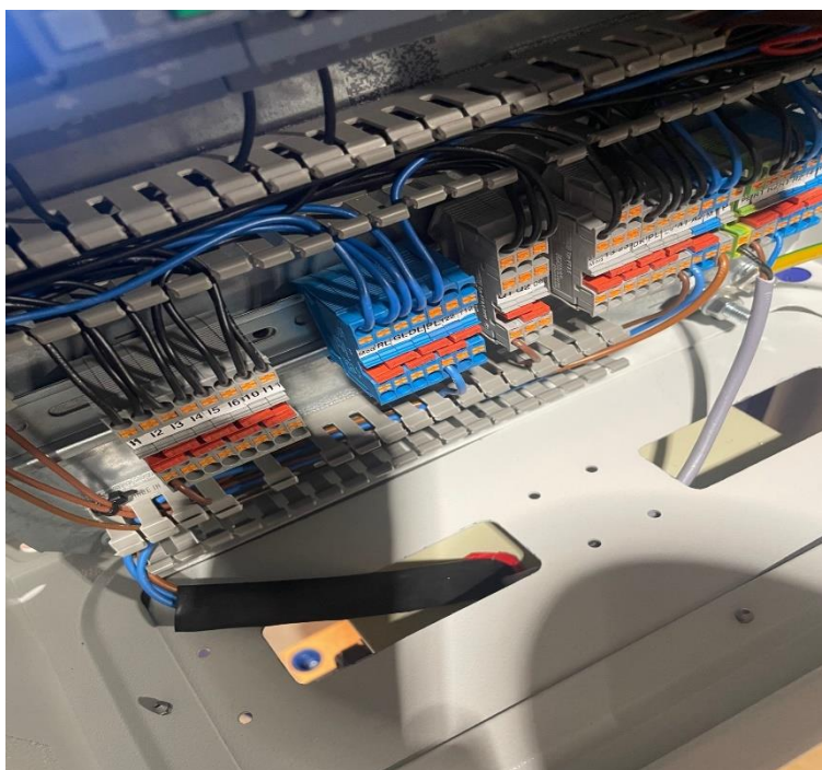
Fig 2. Kabeldragningen mellan elskåpen
