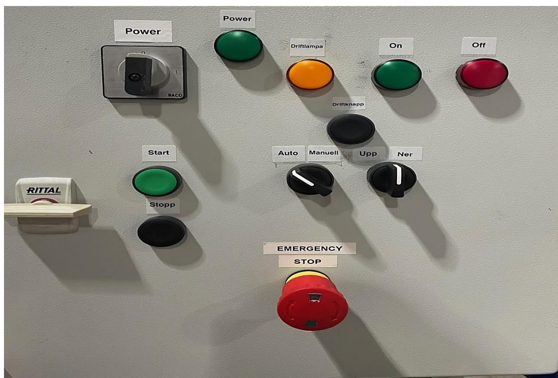
Fig 14. Kontrollpanel på styrskåpsdörren
